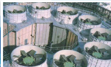
● クーリングタワー／エアフィンクーラ
